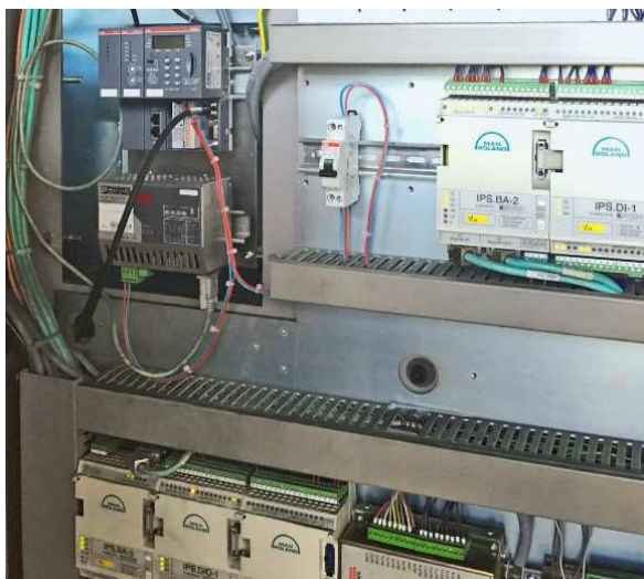
Die neue ABB-Steuerung in Betrieb neben alten PECOM-Steuerungen in Bordeaux
